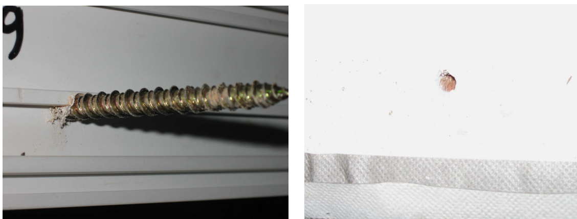
Bilder 12 und 13 Zustand der Rahmenschrauben und Bohrungen nach der durchgeführten Prüffolge
